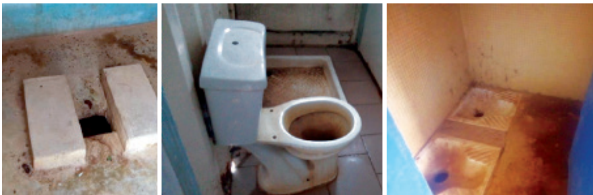
Figure 29 : Vue de latrines non hygiéniques enregistrées dans les EPS au niveau national
