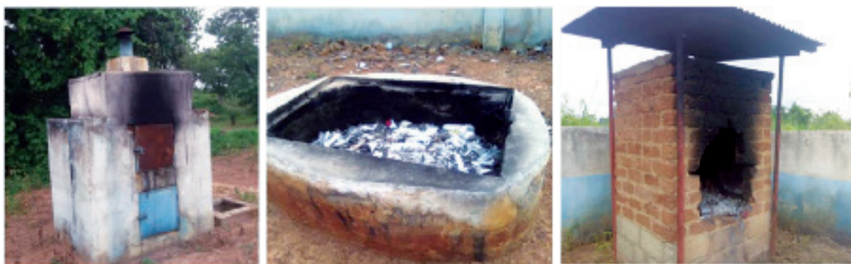
Figure 55 : Vue de quelques équipements de traitement des déchets sanitaires dans les EPS au niveau national
