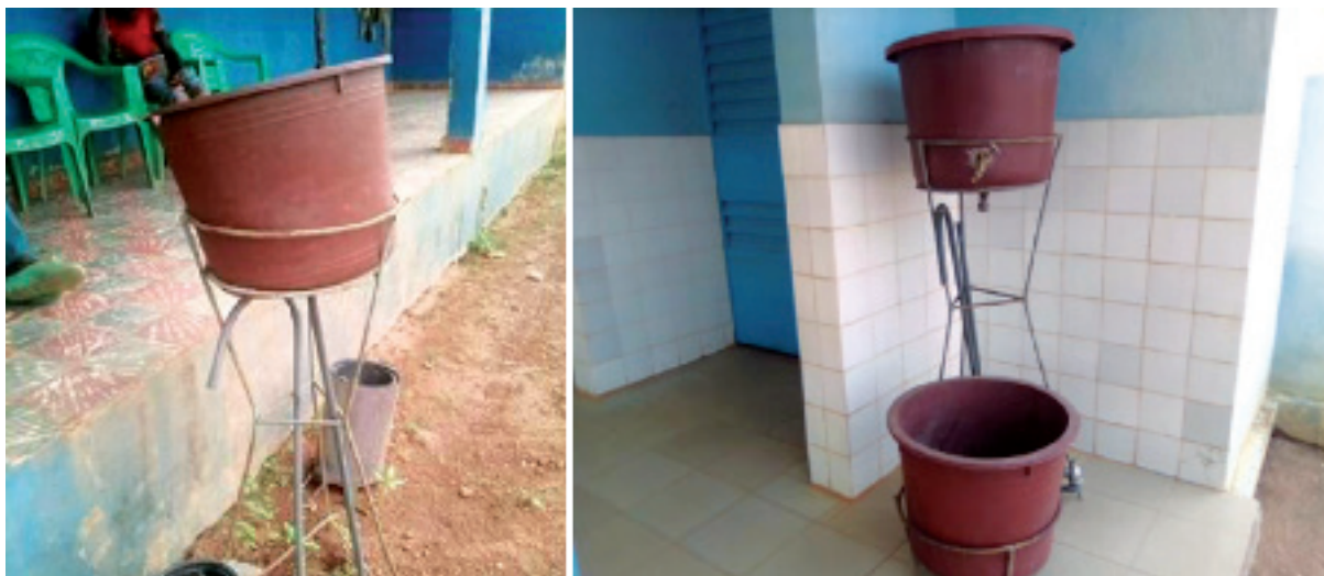
Figure 40 : Vue de dispositifs de lavage des mains (DLM) non fonctionnels observés dans les EPS
